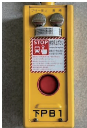
非常停止ボタン
