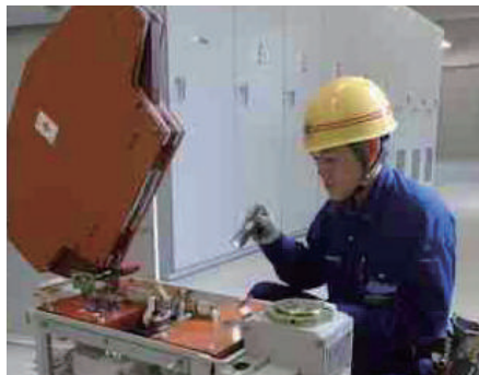
変電所設備の点検
