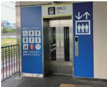
車いす対応のエレベーター
