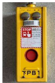
非常停止ボタン
