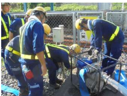
排水ポンプの取扱い（施設区）
