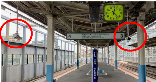
駅ホームの防犯カメラの設置
