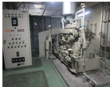
非常用発電機
