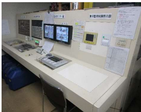
防災総合監視盤
