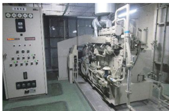
非常用発電機
