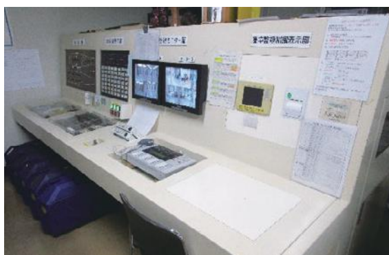
防災総合監視盤
