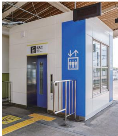
エレベーター
