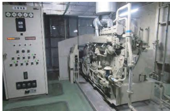
非常用発電機
