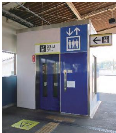
エレベーター
