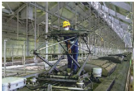
パンタグラフの点検
