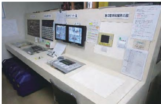
防災総合監視盤
