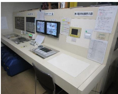
防災総合監視盤
