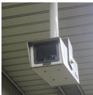
駅構内の防犯カメラ
