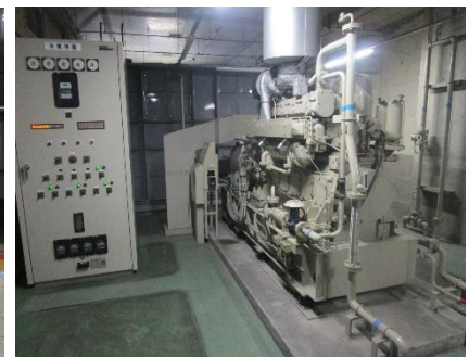
非常用発電機
