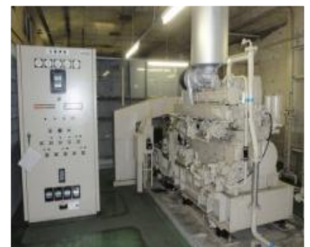
非常用発電機
