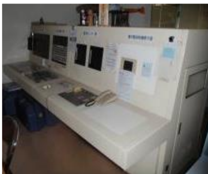
防災総合監視盤
