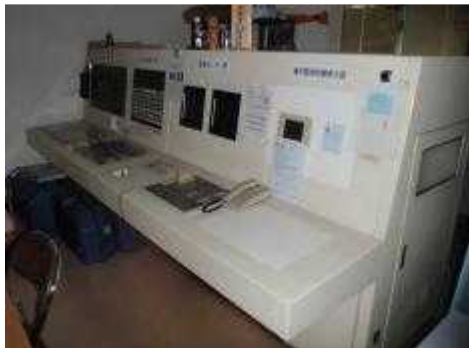
駅務室内総合防災盤
