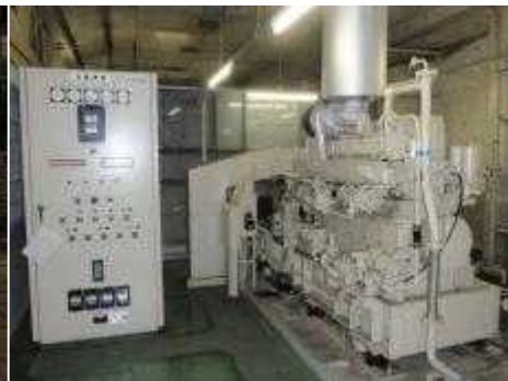
非常用発電機
