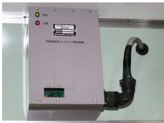
列車無線非常時の電源
