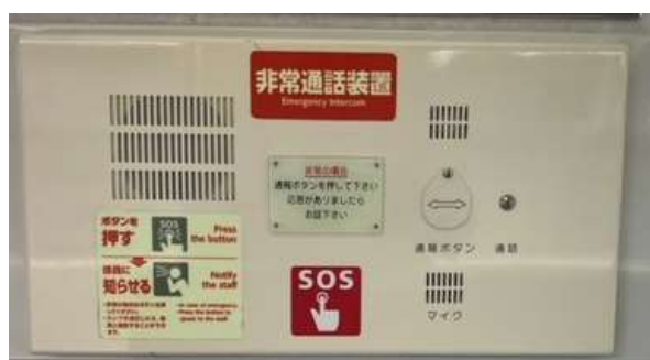
非常通話装置
